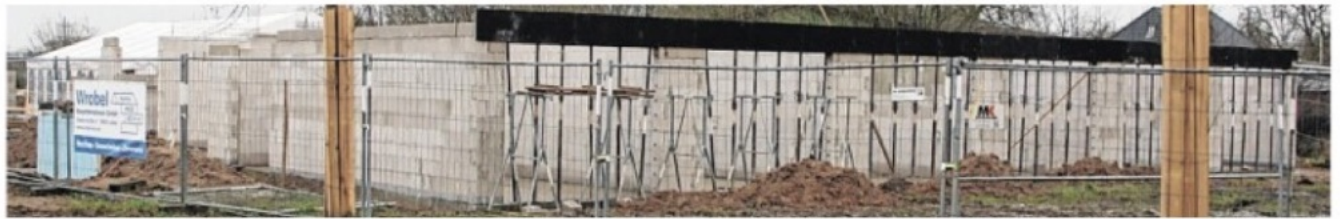
Die ersten rohen Wände stehen bereits: Das Bauvorhaben des neuen Hospizes liegt zwei Wochen vor (!) dem eigentlichen Plan.
